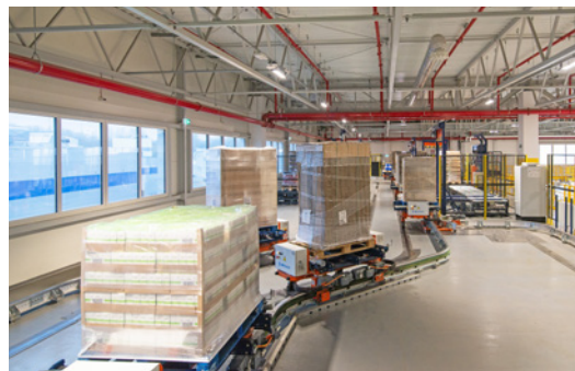
Système de convoyeurs au sol composé de 15 navettes électriques assurant un transport synchronisé, sécurisé et traçable des marchandises entre la production et l'entrepôt.
