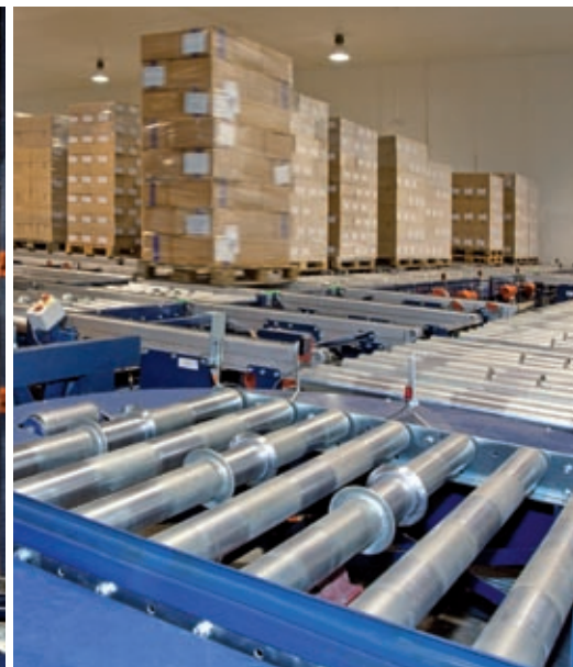
Conveyeurs pour zone de préchargement.
